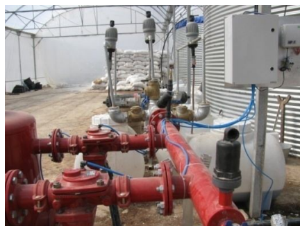
شکل 45- تزریق کود با استفاده از پمپ دیافراگمی با استفاده از نیروی مکش سیستم آبیاری
